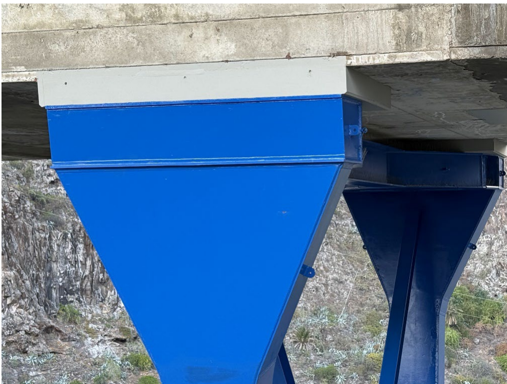
Figura 32. Aspecto final de la unión entre el puntal metálico y el tablero del viaducto, constituida por los macizos de grout
