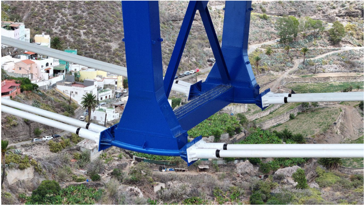
Figura 20. Detalle de los tendones pasantes por el extremo inferior del puntal desviador
