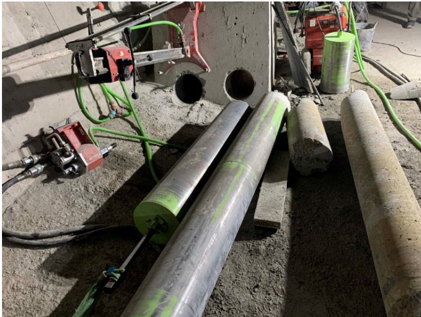
Figura 33. Agujeros ejecutados, de 28 cm de diámetro, en la losa inferior del tablero y testigos de hormigón extraídos.
