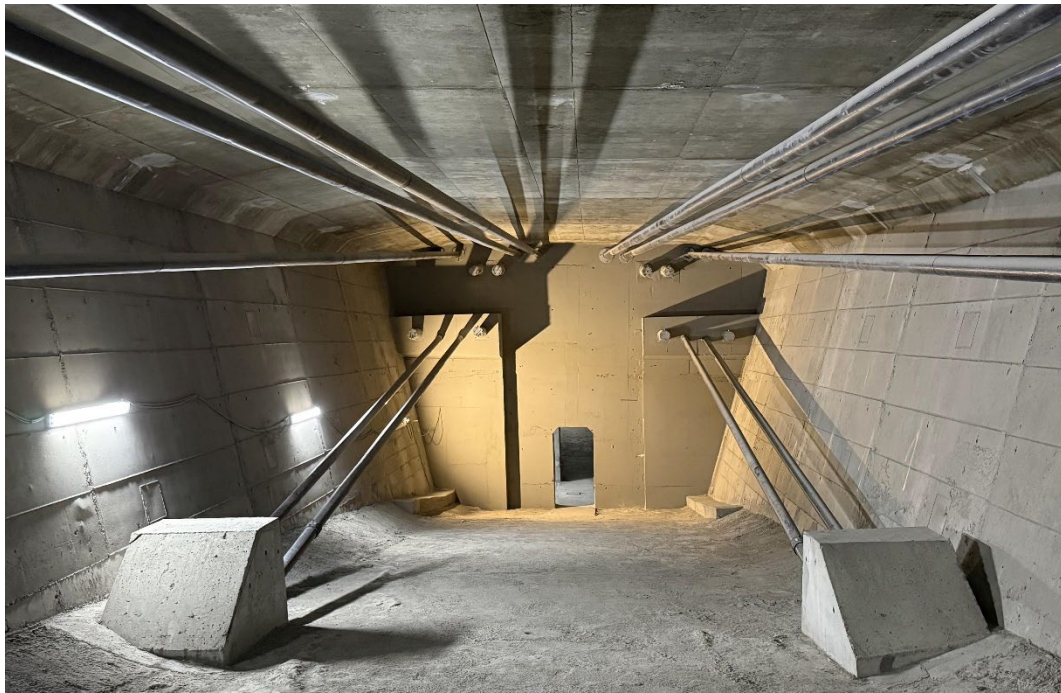
Figura 22. Vista de los tendones, en el interior del tablero (8 tendones de pretensado exterior, en la zona superior y los 4 tendones inclinados del atirantamiento, que atraviesan la losa inferior)
