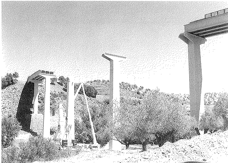
Foto 20. Aspecto del viaducto de Montoro durante el montaje de una de sus pilas prefabricadas.
