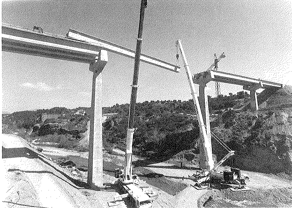
Foto 11. Puente sobre el río Alcanadre (Huesca). Vigas-artesa de 51 m de longitud. Montaje a 50 m de altura con autogrúas de 800 t y 400 t de capacidad.
