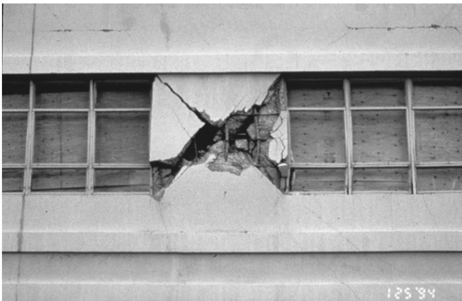
Figura 1. Rotura por cortante de un pilar corto.
