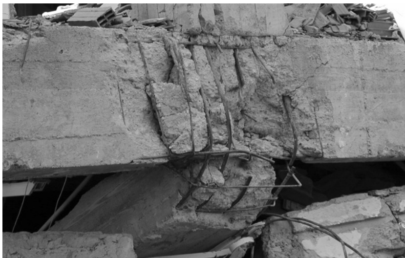
Figura 3. Agotamiento de un nudo de conexión viga-pilar.
