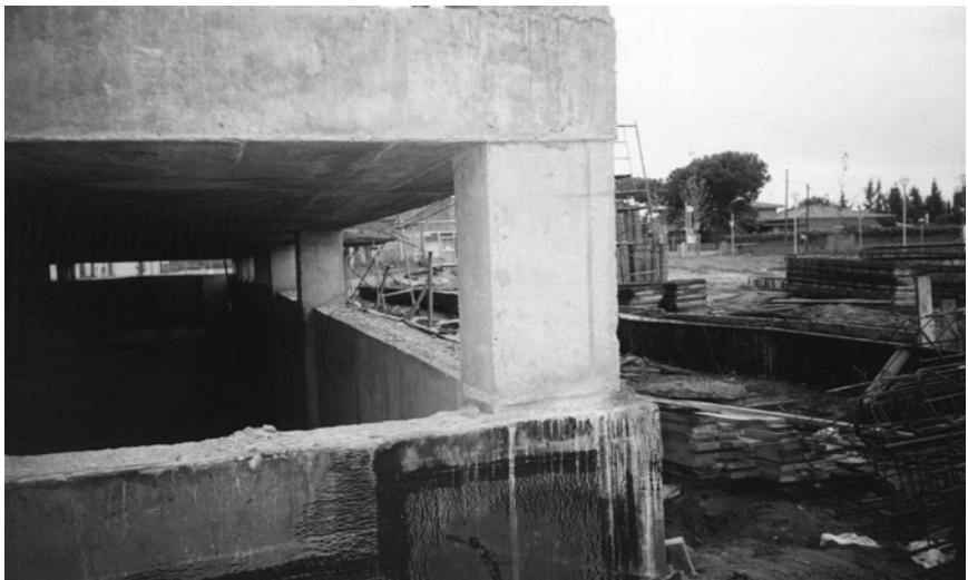
Figura 6. Pilares cortos perimetrales en la base de un edificio.
