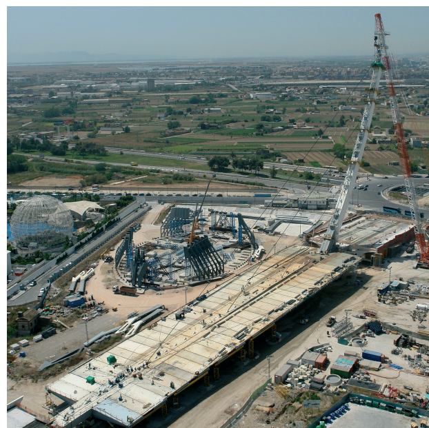
Figura 27. Situación de montaje con los tres tirantes provisionales. Figure 27. Erection stage with three provisional stays.
