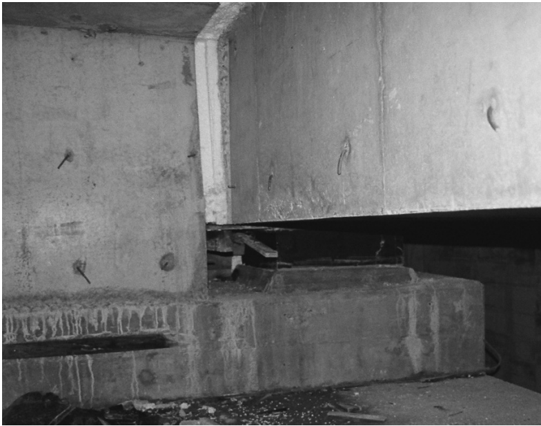
Figura 10 a. Vista de uno de los apoyos inversos desde el interior del cajón de hormigón.
