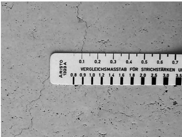
Figura 19. Apertura de fisura máxima pasado un año.
