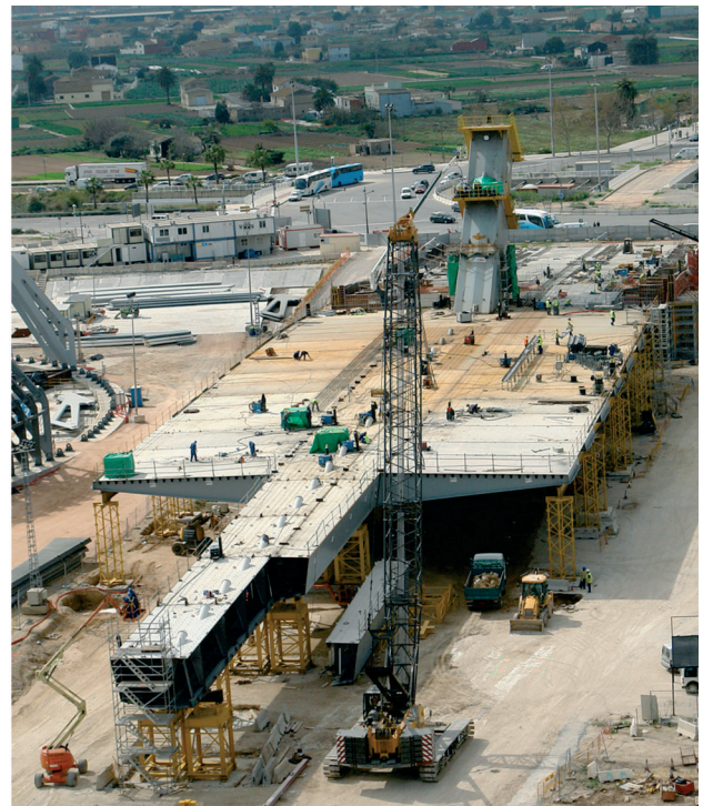
Figura 24. Montaje de tablero y comienzo de pilono. Figure 24. Erection of deck and first stage of pylon.
